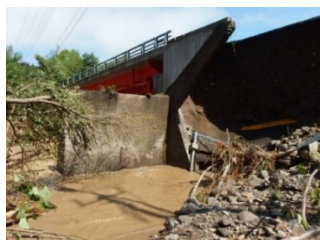
図-1 豪雨災害により橋台背面土が流出した事例
