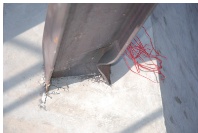
(b) PB 試験体の基部の変形状況
