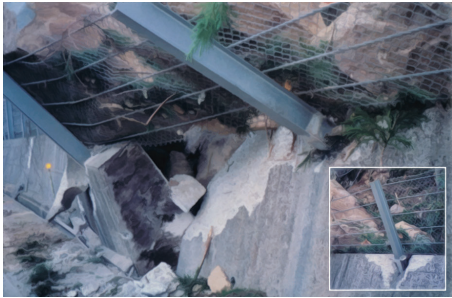
写真-1 支柱基部の損傷例
