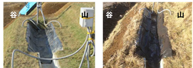
施工時 写真-1 As シート排水溝の変状
