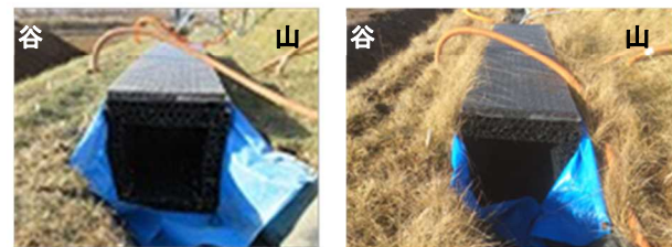
施工時 写真-2 網状構造排水溝の変状
