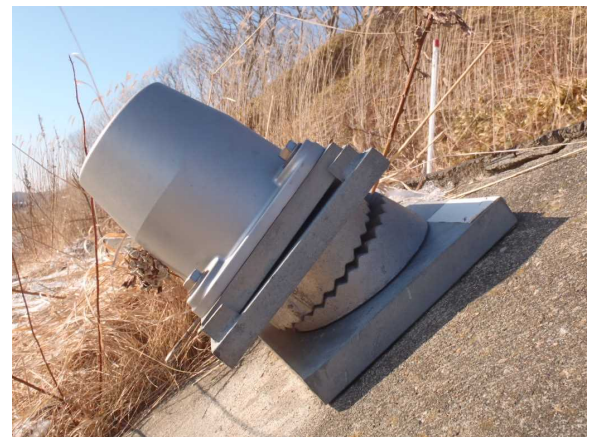
写真-1 グラウンドアンカー頭部の変状
