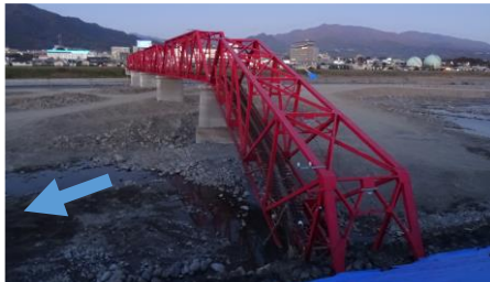
写真-5 長野県上田市のトラス橋梁の被災状況 (2019年11月8日撮影)
