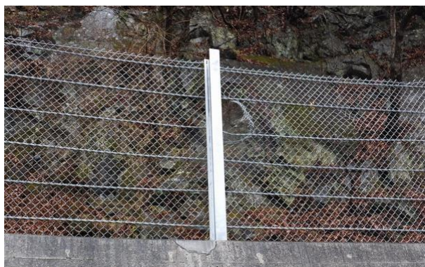
写真-1 従来型落石防護柵の損傷事例（金網の貫通）
