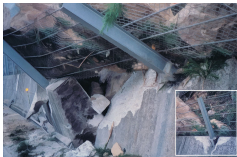
写真-1 支柱基部の損傷例 3)
