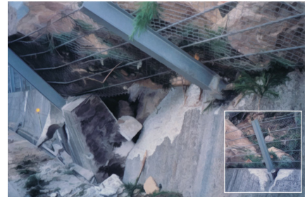
写真-1 支柱基部の損傷例 3)
