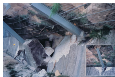
写真-1 支柱基部の損傷例
