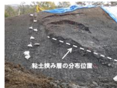
図2 過年度の崩落事例の分析
