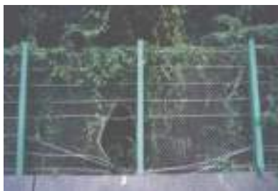
写真-1 被害事例
