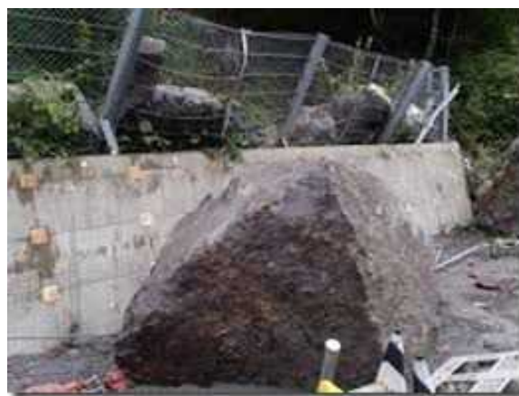
図-2 巨石、落石による破損例
