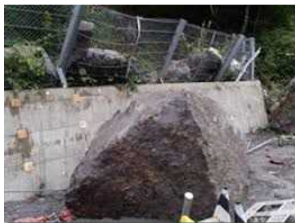
図-2 巨石、落石による破損例
