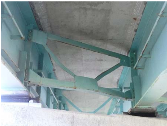
図-15 対傾構の変形（宇隆橋）
