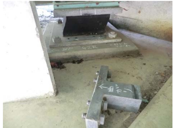
図-16 サイドブロック損傷と支承残留変位（宇隆橋）
