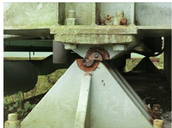
図-7 固定支承の損傷（上厚真大橋）
