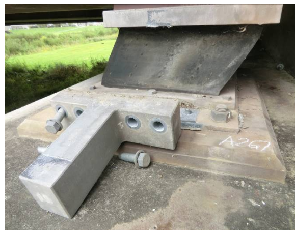
図-3 サイドブロックの損傷(厚真大橋)
