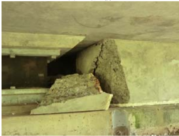
図-9 コンクリートブロックの損傷（北進橋）
