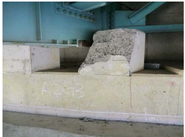
図-17 コンクリートブロック損傷（宇隆橋）
