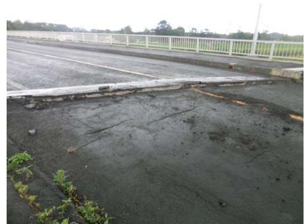
図-5 取付部の段差（厚真新橋）
