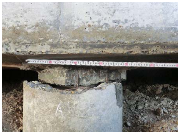
図-13 パイルベントの破断（豊丘新橋）
