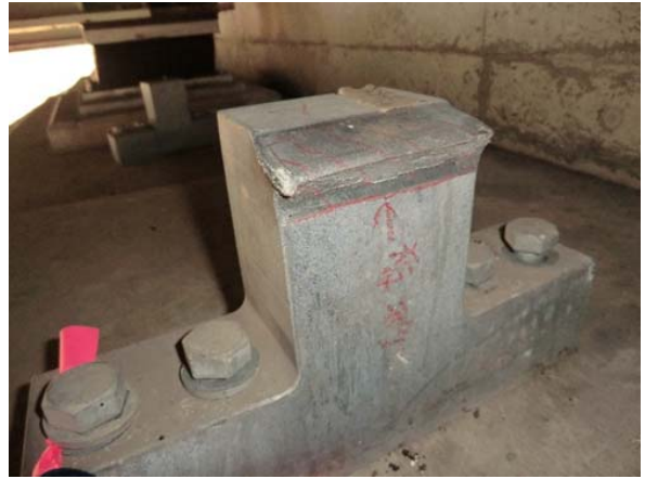
図-11 サイドブロックの損傷（咲来橋）
