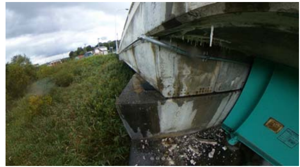
図-4 パット支承のずれ（厚真新橋）
