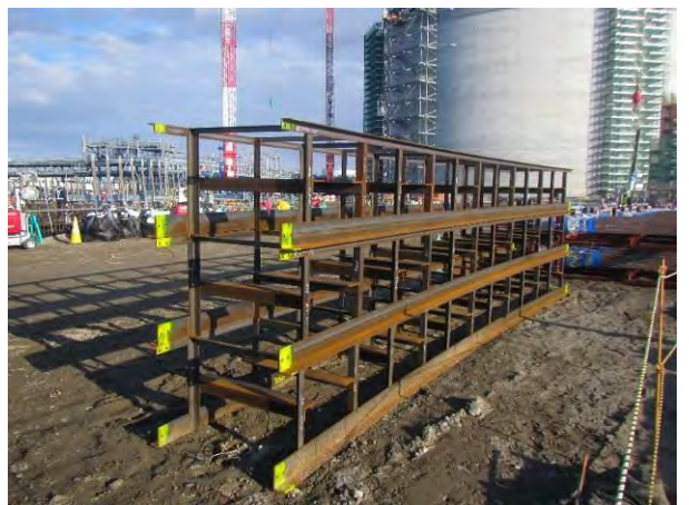
写真-3 アンカーストラップ架台
