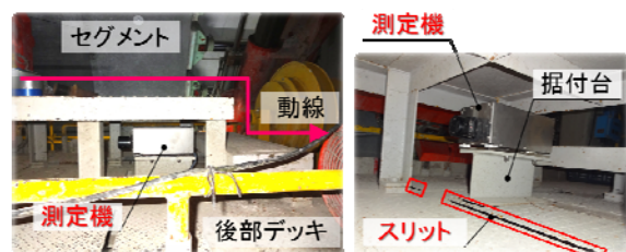
写真-1 後部デッキ下部に設置した測定機の状況 (今回)
