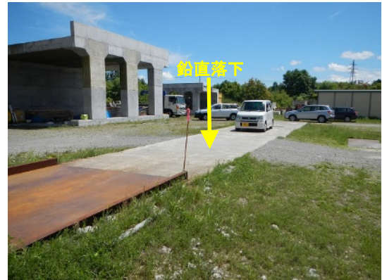
落下対象：(b) コンクリート
