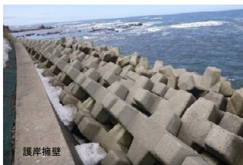
図-1 越波対策対象区間の状況
