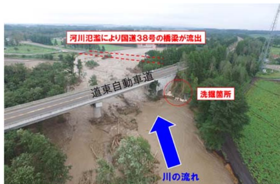
写真-2 小林川橋の洗掘
