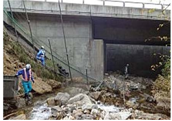
写真-4 洗掘の確認状況
