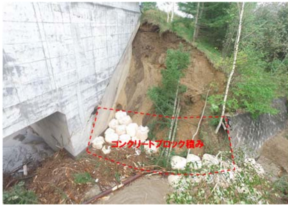
写真-3 洗掘箇所拡大
