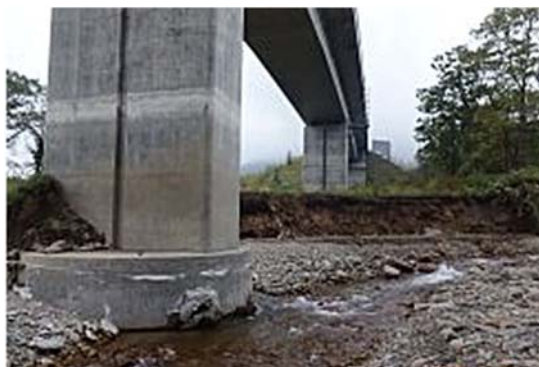
写真-1 洗掘を受けた構造物基礎
