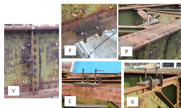
図-4 損傷付加の状態
