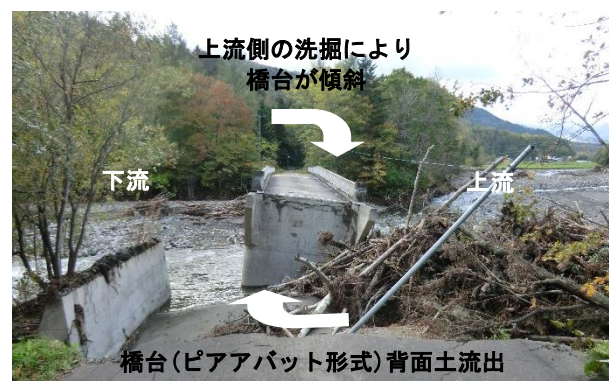
図-2 湯の沢橋の被災状況(左岸から撮影)
