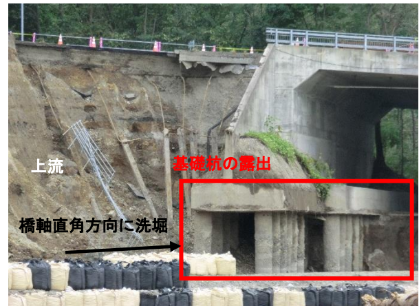
図-1 芽室橋の被災状況(上流より撮影)
