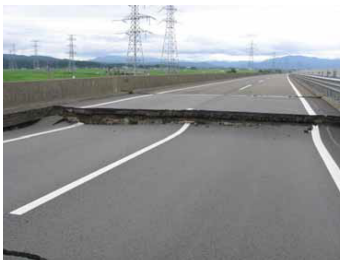
図1 中越沖地震で発生した路面段差 1)
