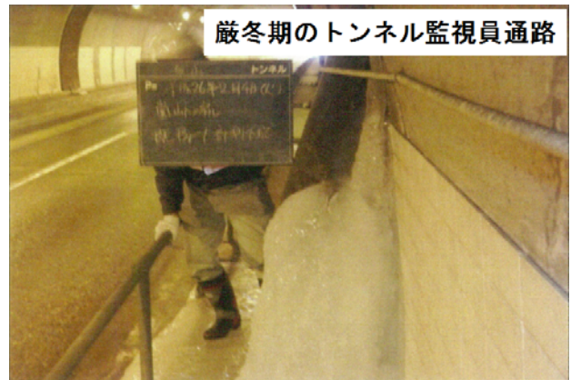
写真-3 監視員通路の氷柱（H26.2）
