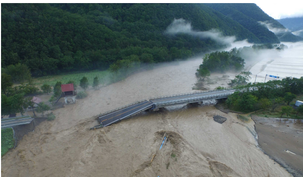
【図4】台風10号による国道274号千呂露橋被災状況
