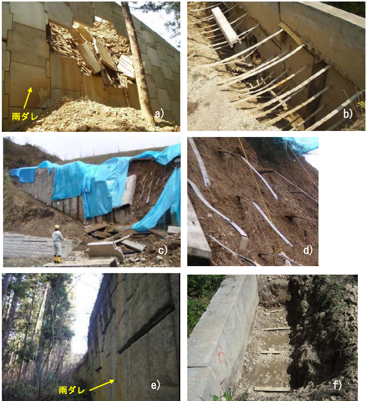
図-3 テールアルメの壁パネル脱落、はらみ出し、ストリップ損傷状況
