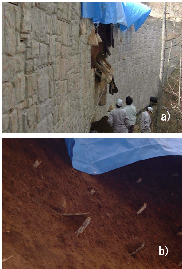
図-6 岡谷市の被災状況
