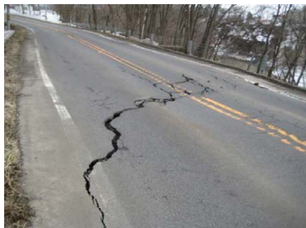
写真-1 対象現場の路面変状の様子
