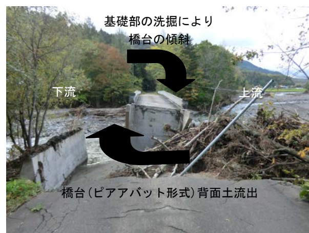
図-3 湯の沢橋の被災状況(左岸から撮影)
