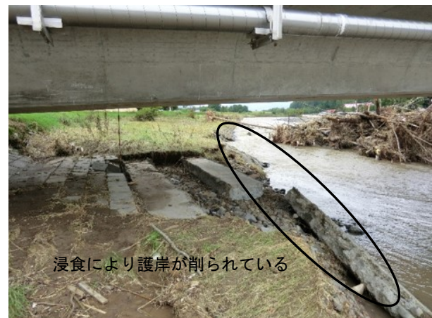
図-11 水郷大橋の被災状況(右岸側)
