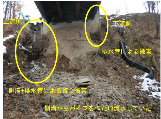
図-8 白花橋の被災状況(左岸全景、復旧工事中)
