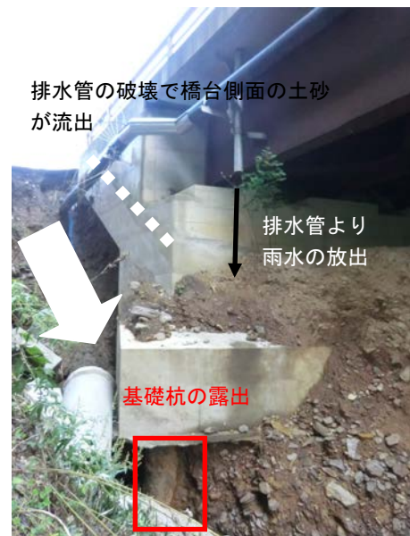
図-7 白花橋の被災状況(左岸上流側)
