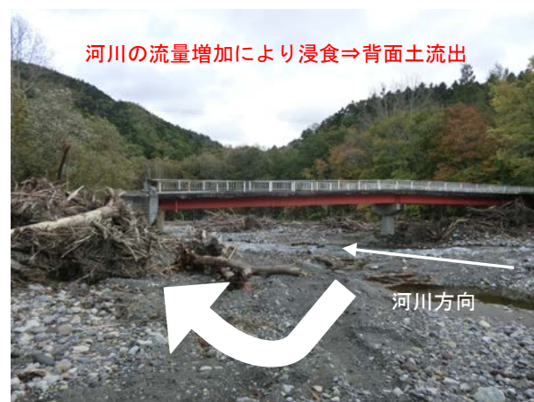
図-4 湯の沢橋の被災状況(上流から撮影)
