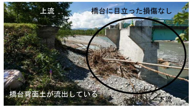
図-5 中島橋の被災状況(右岸橋台)
