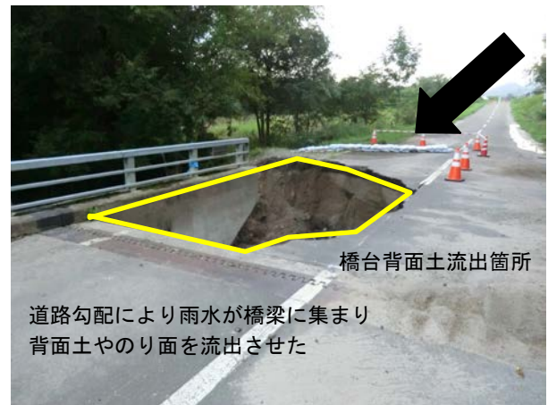
図-9 川上橋の被災状況(右岸側)
