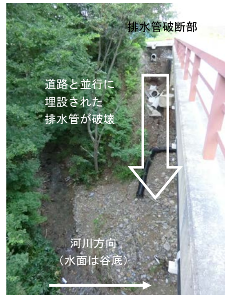
図-6 白花橋の被災状況(橋上から撮影)
