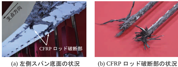
図-6 CFRP ロッドの破断状況
