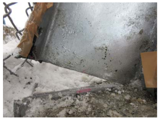
写真-6 中間支柱 S-3 の亀裂 (落下高 7.5m)
