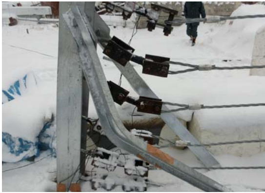
写真-5 端末支柱 S-1 の破損状況 (落下高 7.5m)
