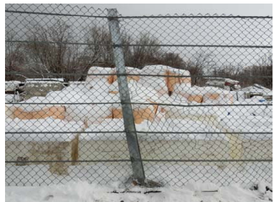
写真-4 中間支柱 S-3 の変形状況 (落下高 3.5m)
