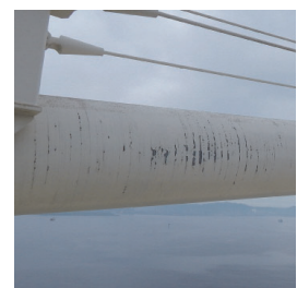
写真-3 塗膜割れの状況(2P)
