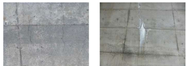
図-4 コンクリート表面の写真
