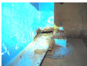
写真-1 損傷状況(正面)
