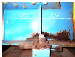
写真-2 損傷状況(側面)
