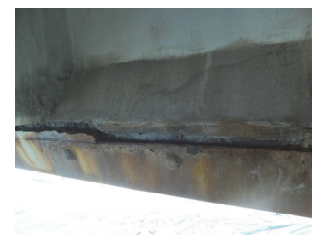
図-2 平成27年時の劣化状況（G2桁）
