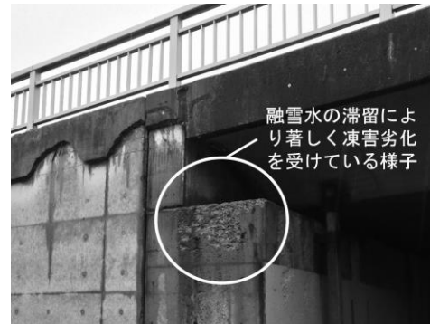
図-1 凍害劣化が生じた橋台
