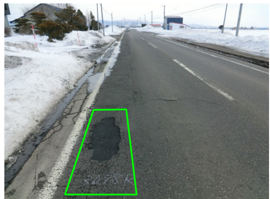
写真-3 写真-2 と同一箇所の目視調査時状況 （ポットホールが発生し穴埋めされている）
