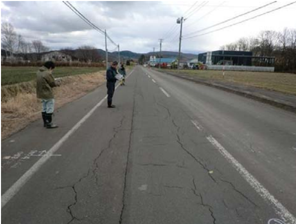
写真-1 目視による舗装の点検状況（ひび割れ）
