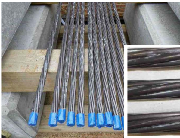
写真-5 一時防錆処理済み PC 鋼材の腐食状況 (PN-7)
