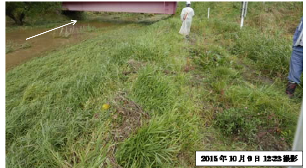
図-8 サラカオーマキキン川上流側堤防裏法浸食箇所天端の痕跡
