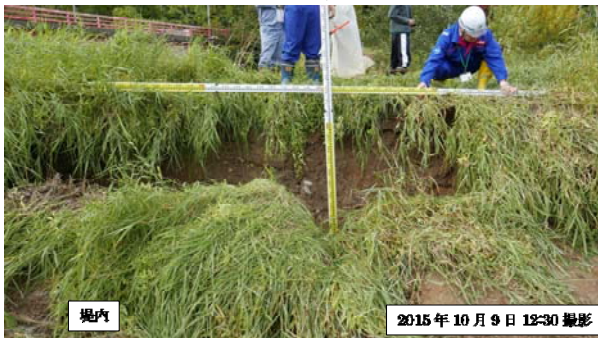
図-13 破堤箇所直上流の法面の浸食状況
