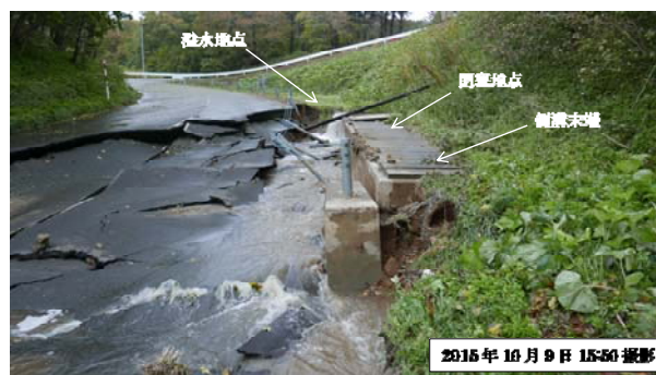
図-21 道路側溝端末からあふれ出た雨水により道路基盤が流失した状況
