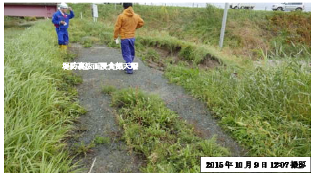
図-9 サラカオーマキキン川上流側堤防裏法浸食箇所天端の状況
