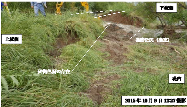
図-11 堤内側から見た破堤の状況
