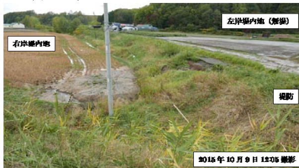
図-6 サラカオーマキキン川上流側堤防裏法浸食箇所
