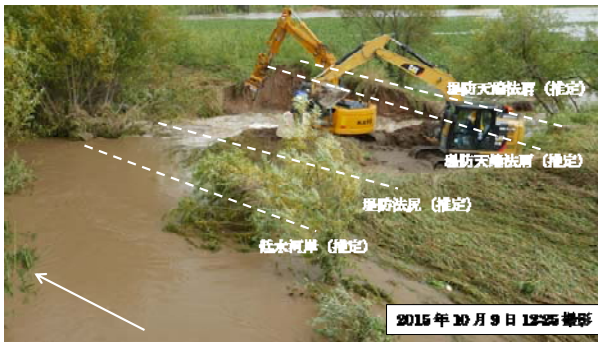
図-10 堤外川から見た破堤の状況
