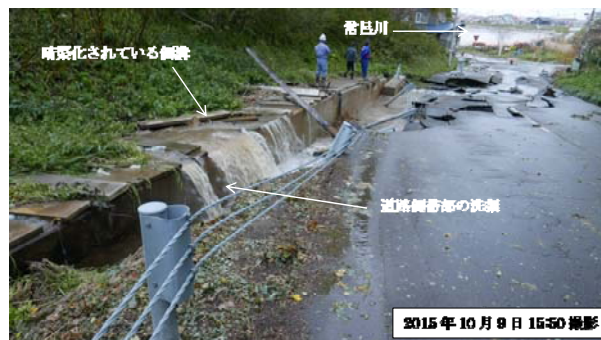
図-22 道路側溝と道路との間の地盤が流失した状況
