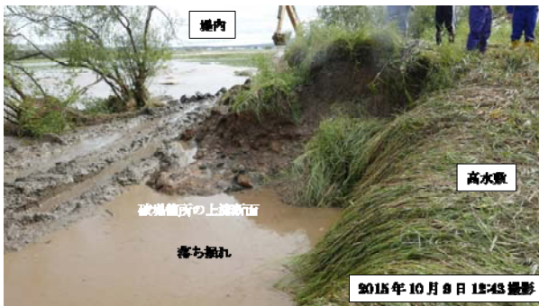
図-12 破堤部上流断面
