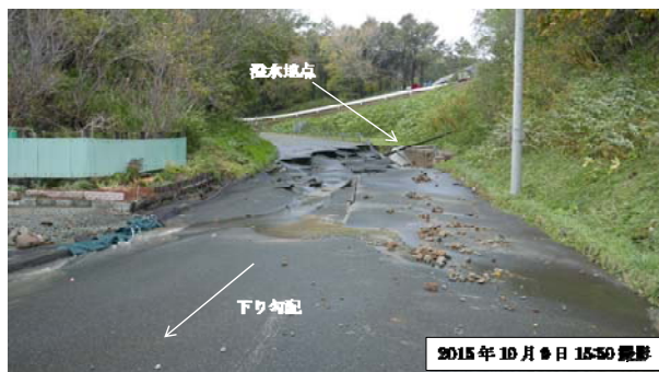
図-20 北見市道被災地点周辺の状況
