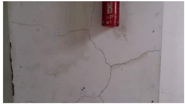
図-4 ひび割れ写真
