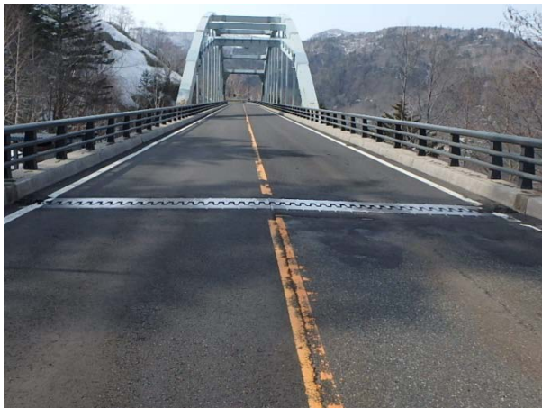
写真-2 段差擦り付け前の伸縮装置付近の状況
