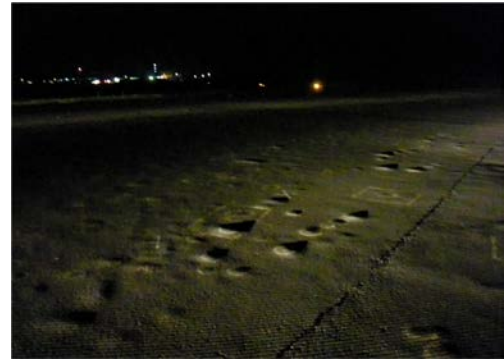
写真-1 道内空港で発生したブリストリング現象
