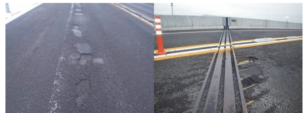
写真-1 排水性舗装の破損事例（タイヤ走行部（左）と 橋梁ジョイント部（右）のポットホール）
