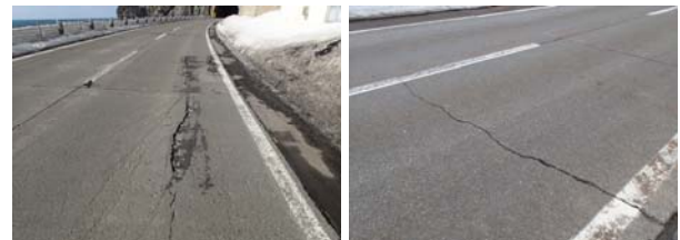
写真-1 ひび割れ(縦断)
