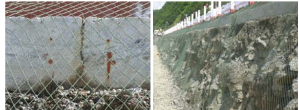
写真-3 目地部側面の状況
