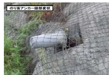
写真-4 アンカーキャップの突出状況
