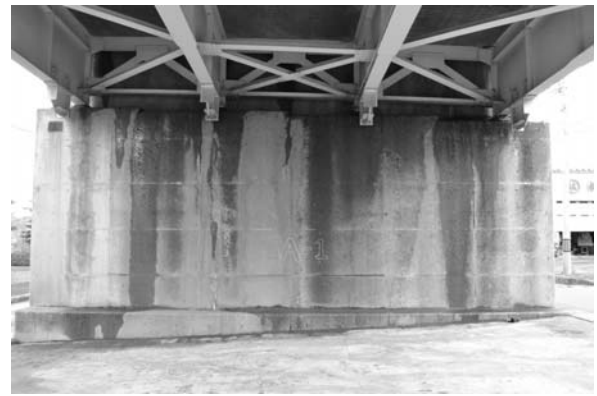
写真-1 橋台正面部劣化状況の一例
