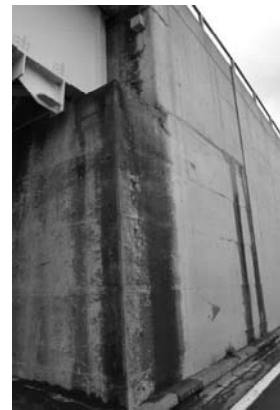
写真-2 橋台側面部劣化状況の一例
