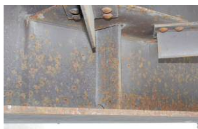
写真－3 ラスコール（本線橋）
