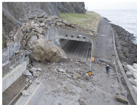
写真-1 北海道の落石による道路災害例(2008)
