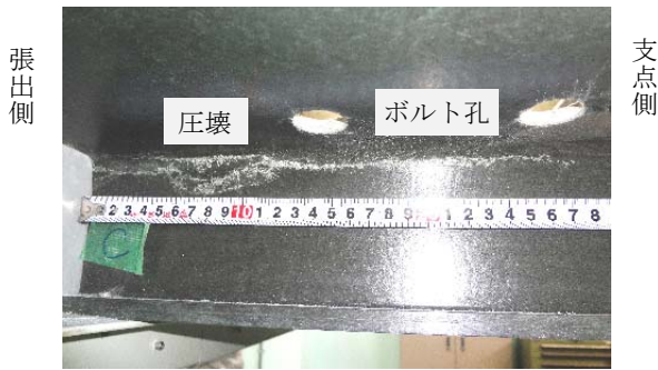
写真-1 ウェブ A の損傷状況
