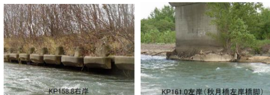
図-1 河床低下に伴う構造物への影響の様子
